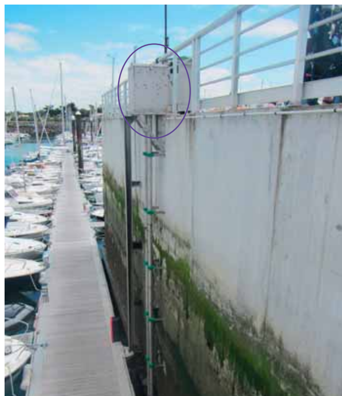
Le nouveau marégraphe de l'Herbaudière
