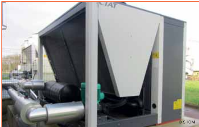
Groupe froid CIAT pour la production d'eau glacée du circuit de climatisation des salles informatiques et de locaux techniques
