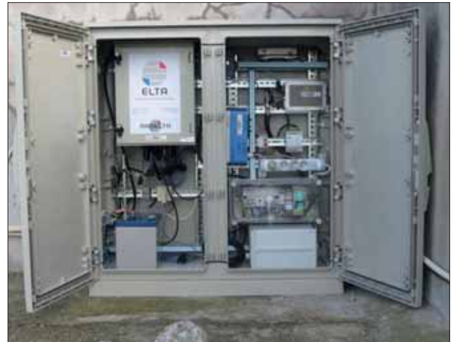
Centrale d'acquisition, transmissions temps réel et batteries à Solenzara
