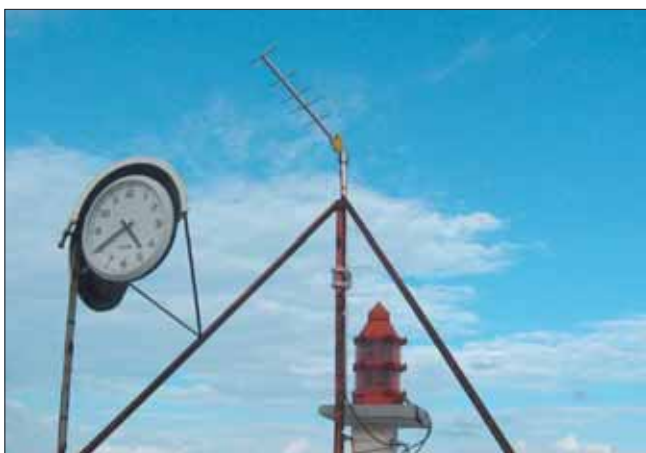
Fig.13 : Antenne de transmission vers Météosat-9 installée sur le site du MCN de Dzaoudzi (Mayotte)
