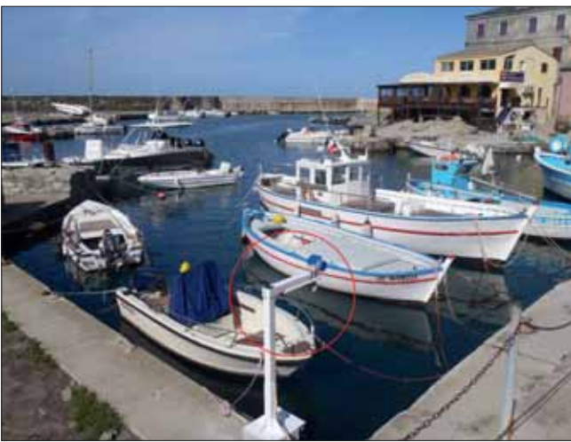
Télémetre radar sur sa potence dans le port de Centuri
